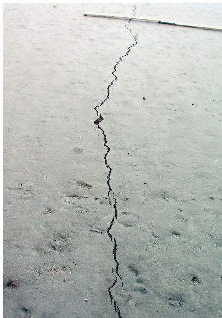
Figur 1: Exempel på oacceptabel sprickbildning.
