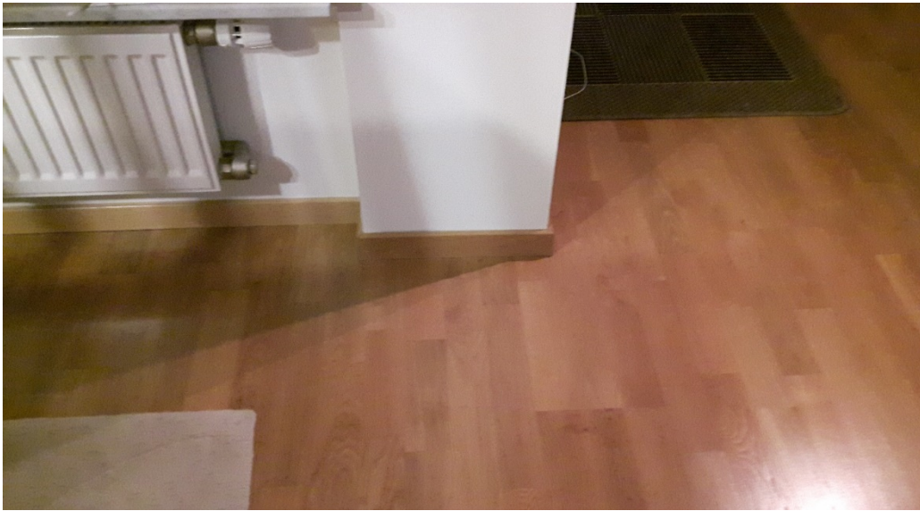
Vattenläckan från lägenheten två våningar upp upptäcktes när parketten vid pelaren började svikta. Hela golvet fick bytas ut.
