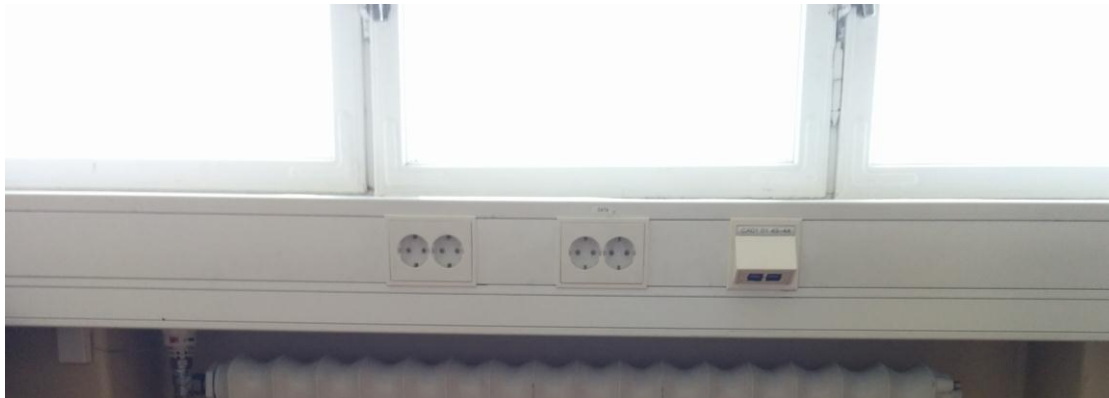
Bild 29. Kabelränna monterad under fönster i rivningsgavel. Författarnas egen bild.
