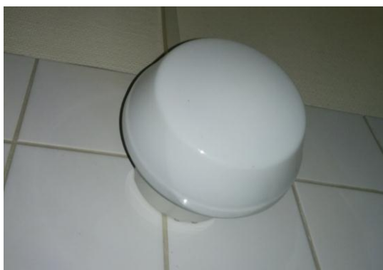
Bild 17. Belysningsarmatur på toalett. Författarnas egen bild.
