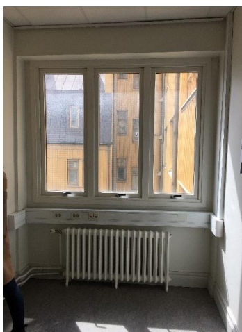
Bild 23. Fönster i rivningsgavel, författarnas egen bild.
