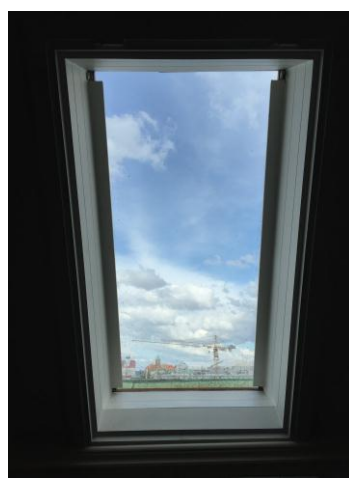
Bild 24. Fönster i rivningsgavel, författarnas egen bild.
