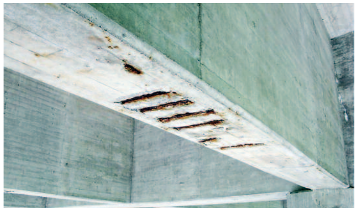
Figur 5: Exempel på en skada med bortspjälkat täcksikt, Blommenbergsviadukten.
