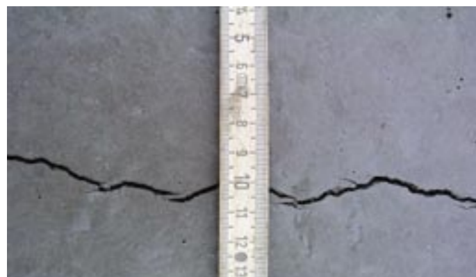
Exempel på plastisk krympspricka. Fotografi från fältförsök med betong som efterdoserades med 0,2% flytmedel.
