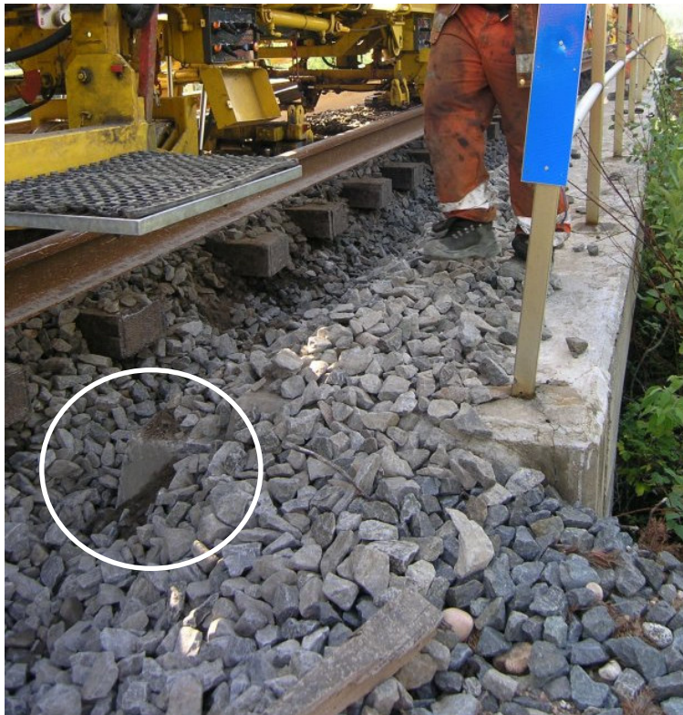
Figur 3.8 Överskottsballast och slitage på kantbalken efter plogning av bron (foto: David Lehtonen)
