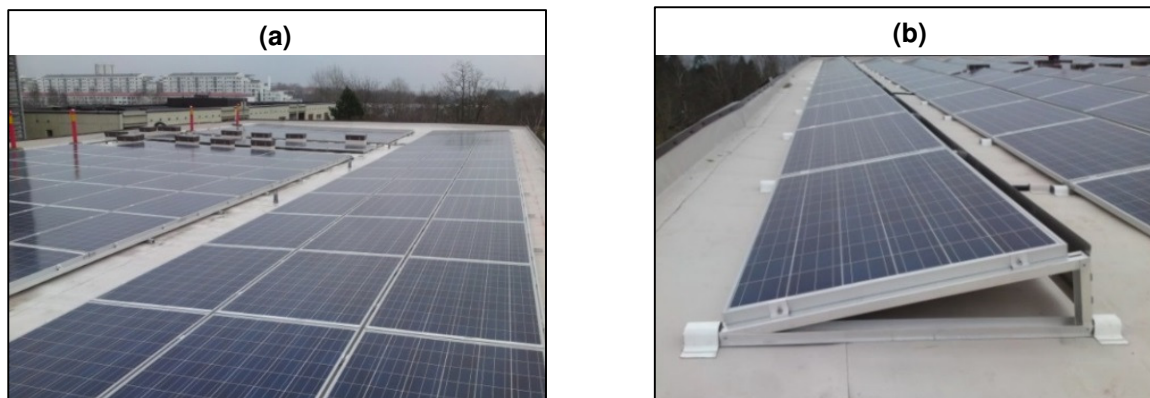
Figur 3.3 Platt tak med takduk på vilket solcellsmoduler monterats (a) horisontellt och (b) uppvtinklat på metallstativ. Foto: Jan-Olof Dalenbäck.
