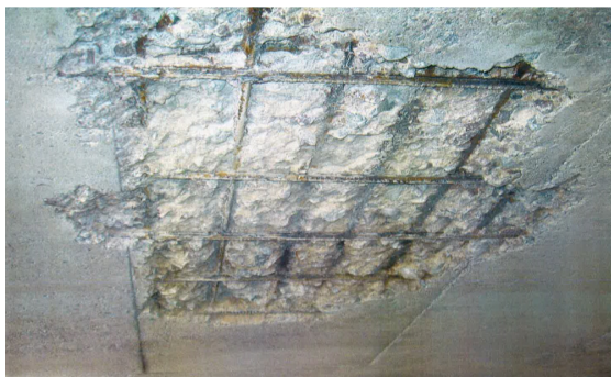
Figur 6.15: Skada i bjälklag. Återgiven med tillstånd
