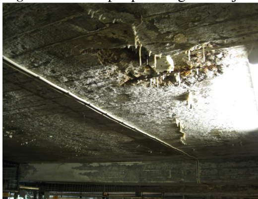
Figur 6.9. Urlakning på insida bjälklag. Återgiven med tillstånd.
