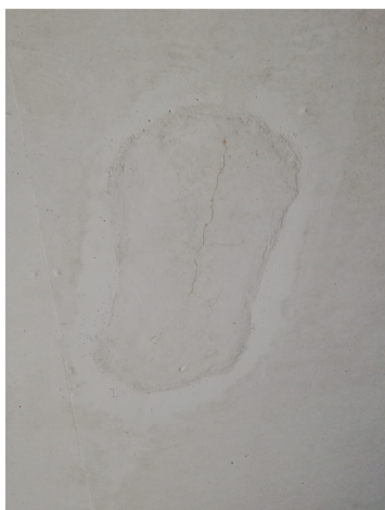
Figur 6.2. Spricka i lagning. Författarens egen bild.
