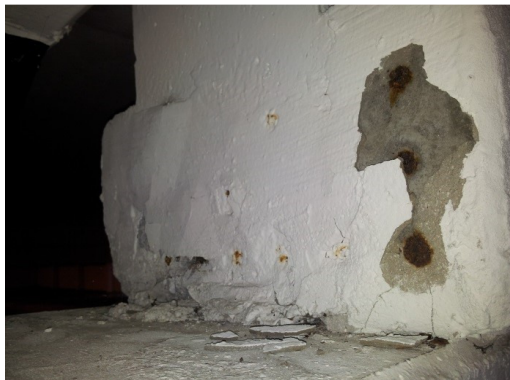
Figur 6.5. Balkända varvid betong har spjälkat. Återgiven med tillstånd.
