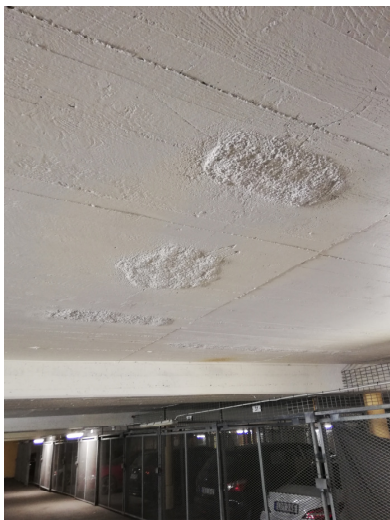
Figur 6.13. Drygt 80 st lagningar upptäcktes med estetiska defekter. Författarens egen bild.
