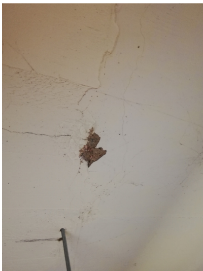
Figur 6.14. 9 st lagningar upptäcktes som spjälkat och spruckit. Författarens egen bild.
