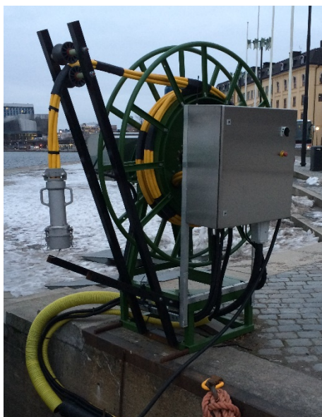
Figur 4. E/S Movitz laddstation med manuell påkoppling.
