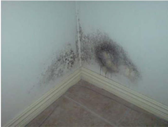
Figur 4.1. köldbrygga med tydlig mögelskada i vinkel där vägg möter vägg
