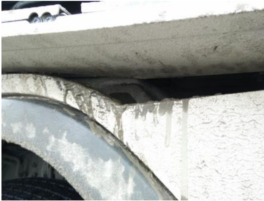
Figur 4.10. Illustration som visar hålrummen under Second Storage. Här Skvätter det bland annat smuts och vatten upp, som lägger sig på locket och kring tätningen.
