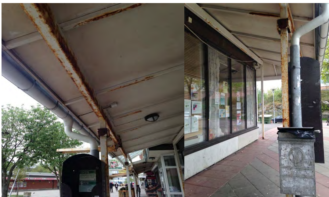
Figur 9(Vänster bild) och 10(höger bild) skärmtak över entréer till Skrapan visar problematiken med underhåll (Författarens egna bilder)
