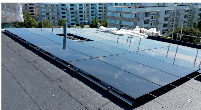
Figur 4: En kanalgenomföring försvårar installationen och påverkar det framtida energiutbytet negativt. Kan den sluta direkt under panelerna?
