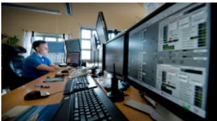
Figur 3. Bilden visar hur det ser ut i kontrollrummet hos en depå där man sköter last- och lossningsoperationer (Nynäs AB).
