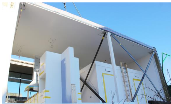
Bild 7, Bostadsmodul HSB Living Lab, 2016 Swedish Modules, Köksluckor och dörrar förtejpade
