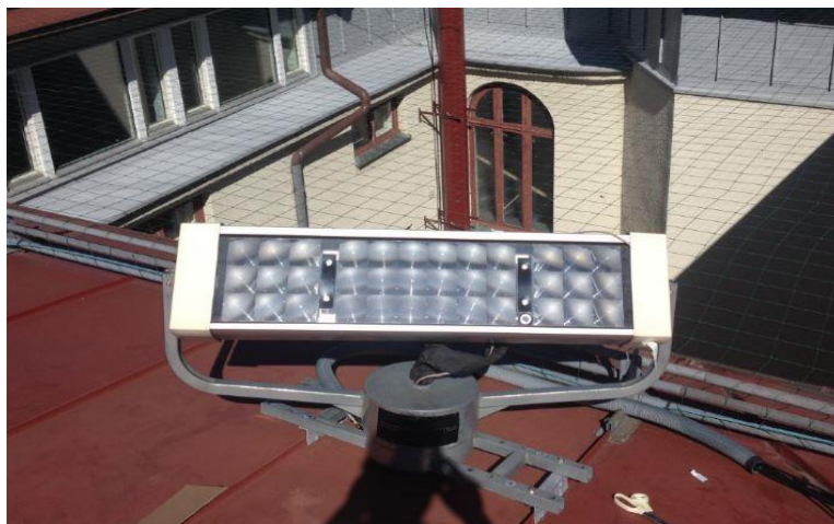
Figur 9. Installerad SP3 på Parans tak.
