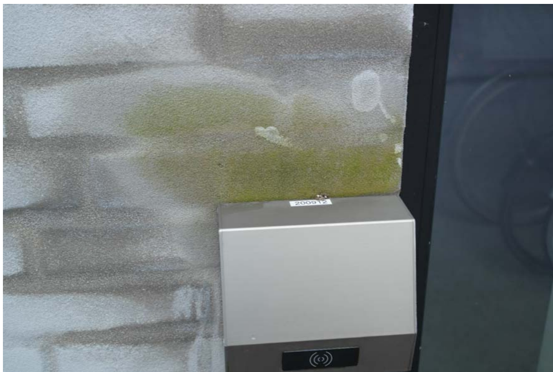
Figur 49. Missfärgningar över portkodläsare. Foto: Författarna.
