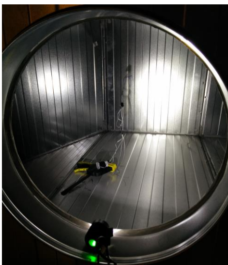
Figur 3.8 Bild på temperaturgivare i en kanal.
