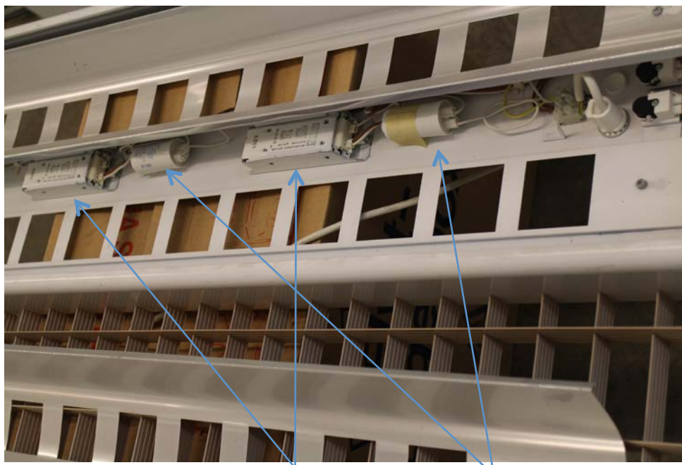
Bild: Öppnad armatur med två drosslar (EM), och två kondensatorer.
