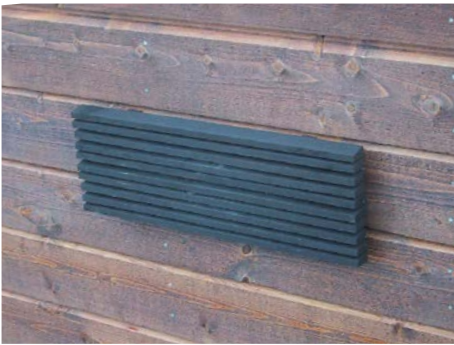
Detalj; utvändigt galler vid luftintag
