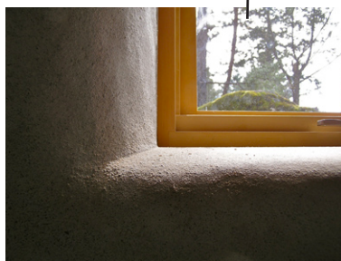
Lerputs vid fönster (Inspirational Village, 2011).
