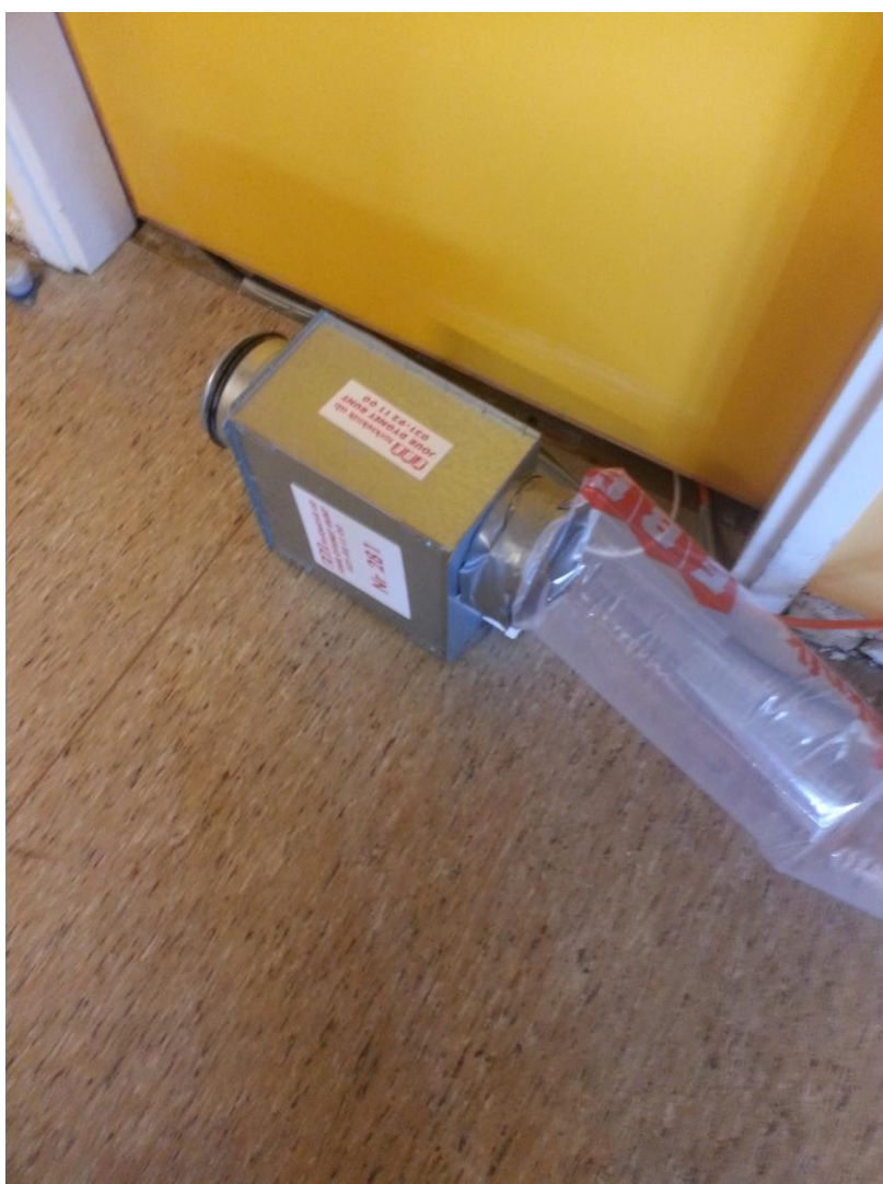
Figur 3.1. Avfuktare kopplad till plaströr. (Foto: Christoffer Mohajer)
