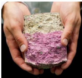
Figur 12 - Den rosa indikatorn visar okarbonatiserad betong (Andersson, 2013).
