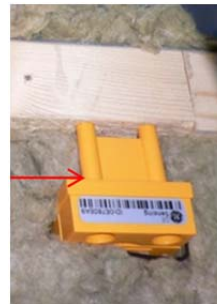
Placering av en fukt- och temperatursensor i ytterdelen av en träregelvägg
