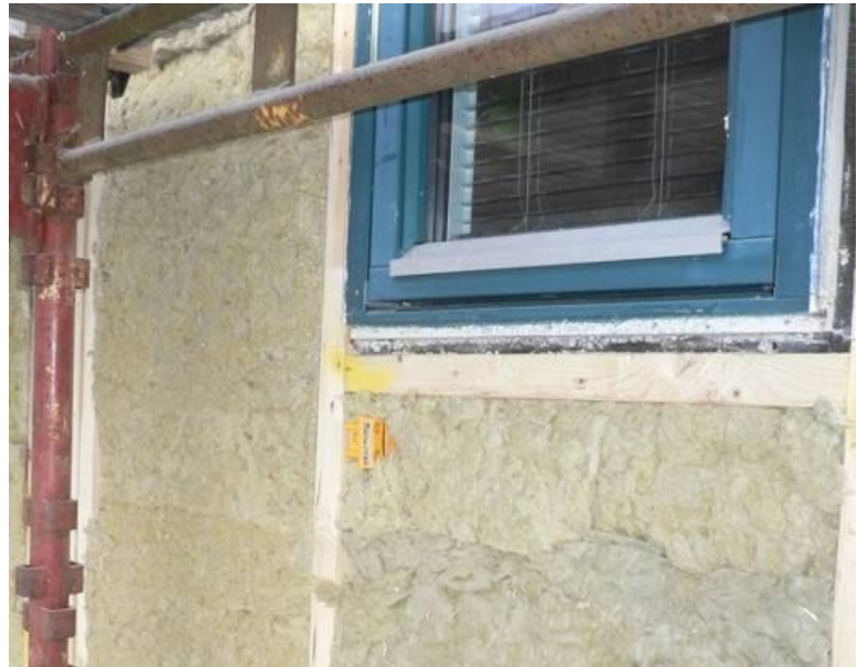
En avklädd regelyttervägg och placering av en fukt- och temperaturgivare alldeles under ett fönster.
