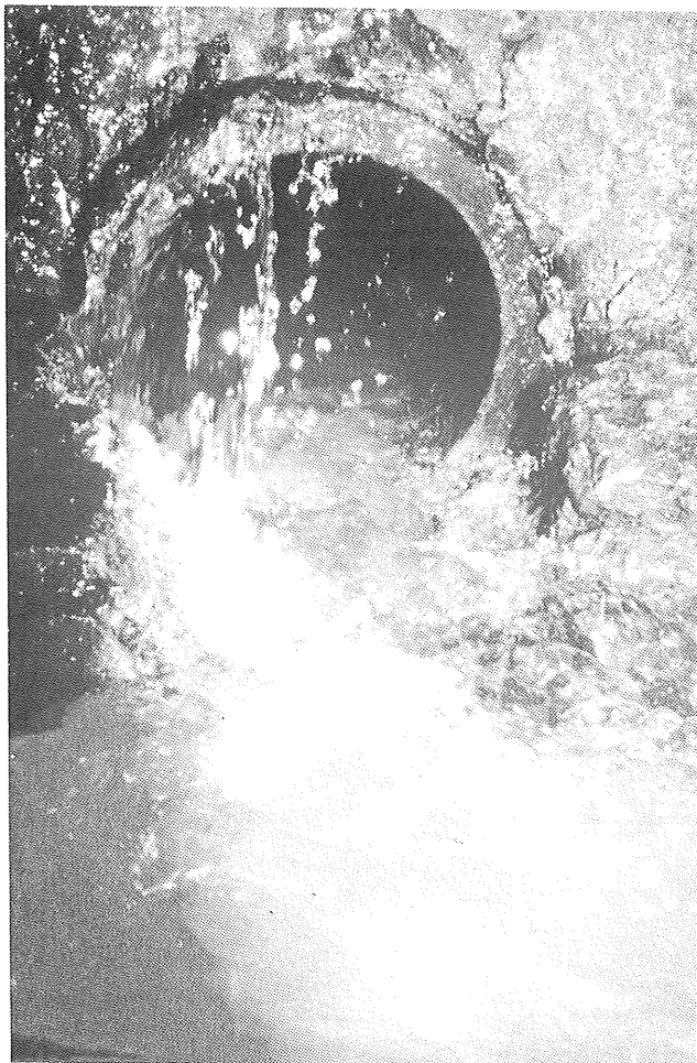
Fig. 2.15 Överläckningsflöden tränger in i otät brunn och brunnsanslutning. (Sträcka nr 323, kap. 3.4.3)
