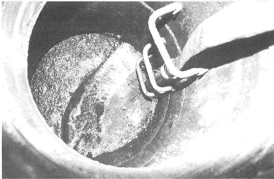
Fig. 2.14 Ett tungt järnrörsmunstycke håller slangen kvar i brunnen. Vid högre flöden måste munstycket säkras mot stegring.
