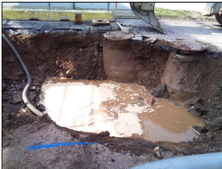
Figur 42. Schaktområde med uppträngande vatten från vattenläckan. Foto: Johan Emanuelsson
