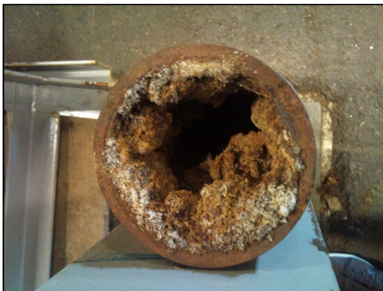
Figur 41. Exempel på utbytt rörsektion där avlagringar tydligt framgår. Foto: Johan Emanuelsson.
