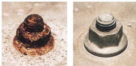
Figur 8.6: Zink/järnytbehandlad stålskruv och mutter, dacrolit-behandlad stålskruv och mutter.
