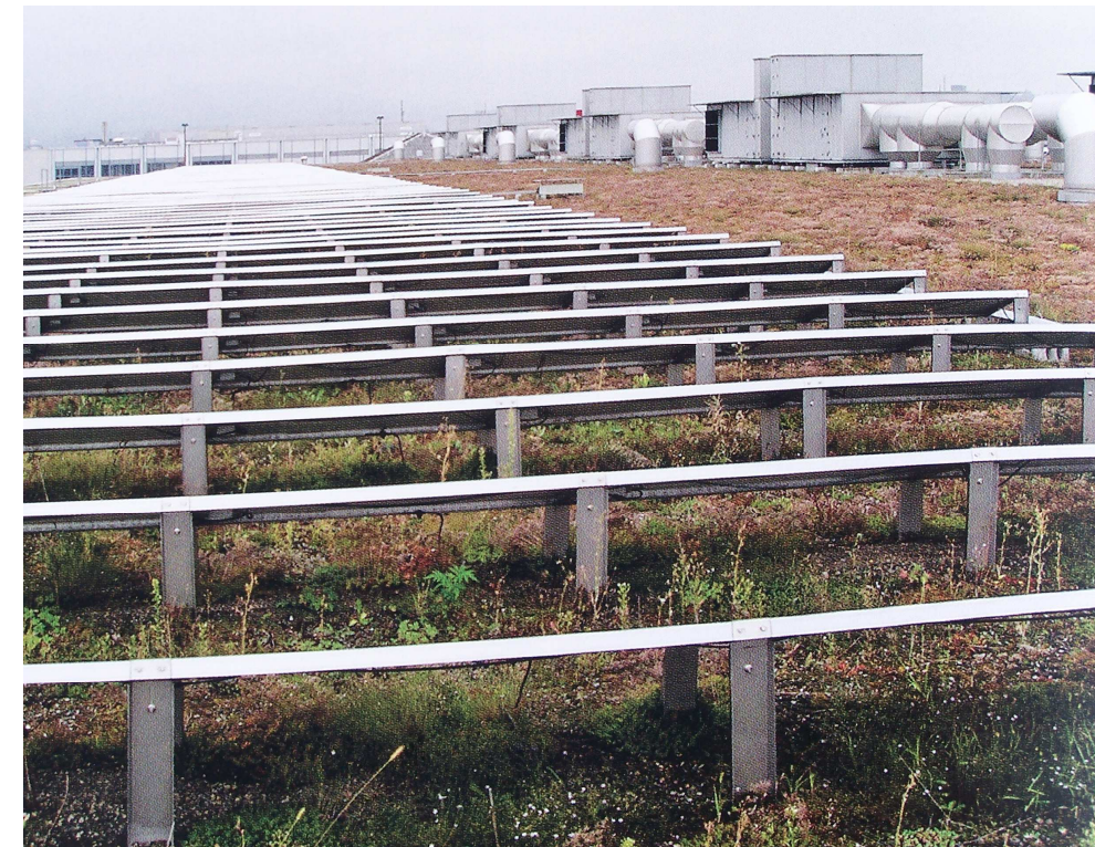
Figur 2: Grönt tak med solpaneler i Basel
